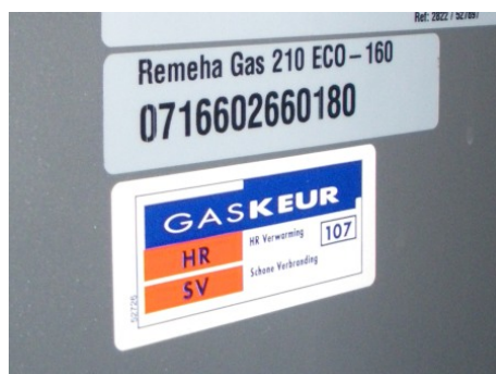
Afb. 9 CV-ketel met HR keur (HR107)
