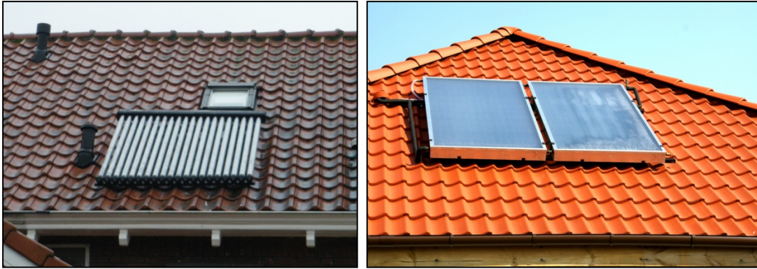
Afb. 15 Zonneboiler met vacuümbuizen (links) en vlakke plaat collectoren (rechts)
