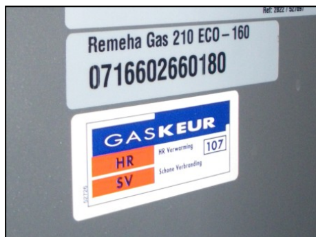
Afb. 9 CV-ketel met HR keur (HR107)
